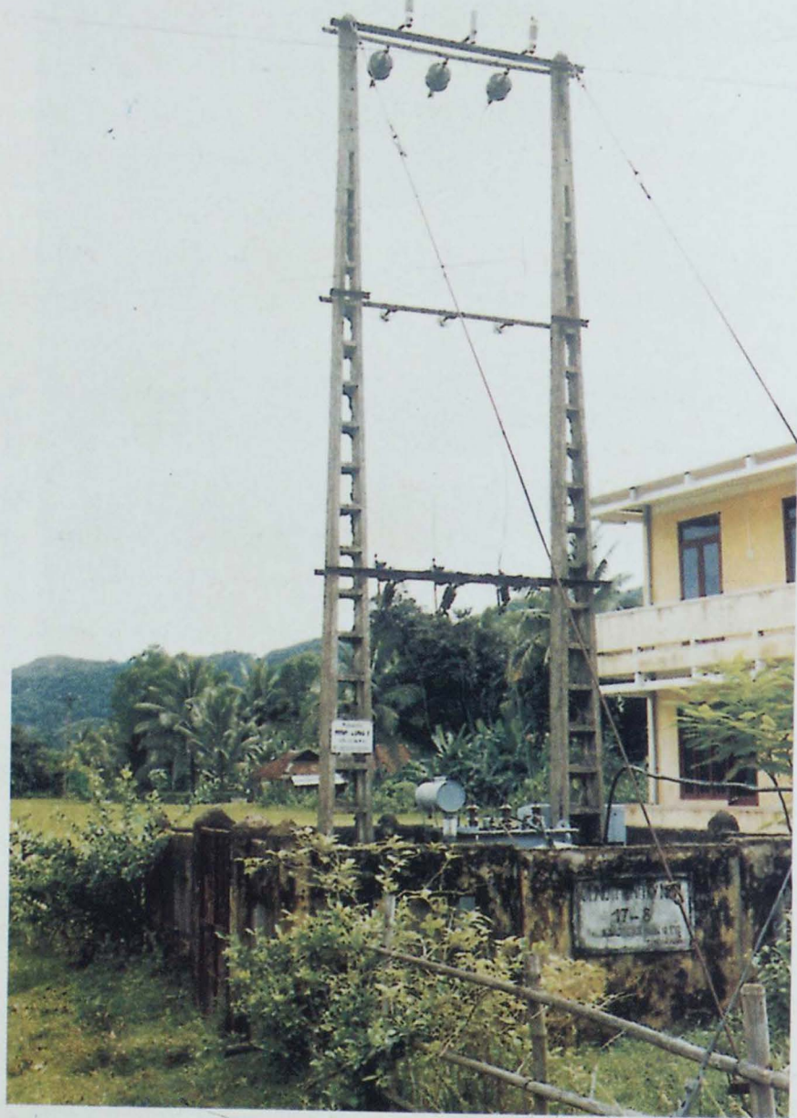
Trạm biến áp điện Minh Long, để : "Núi rừng có điện thay sao"
