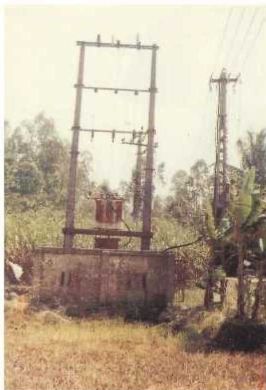
Trạm hạ thế dưa điện lưới quốc gia về Tĩnh Bình
