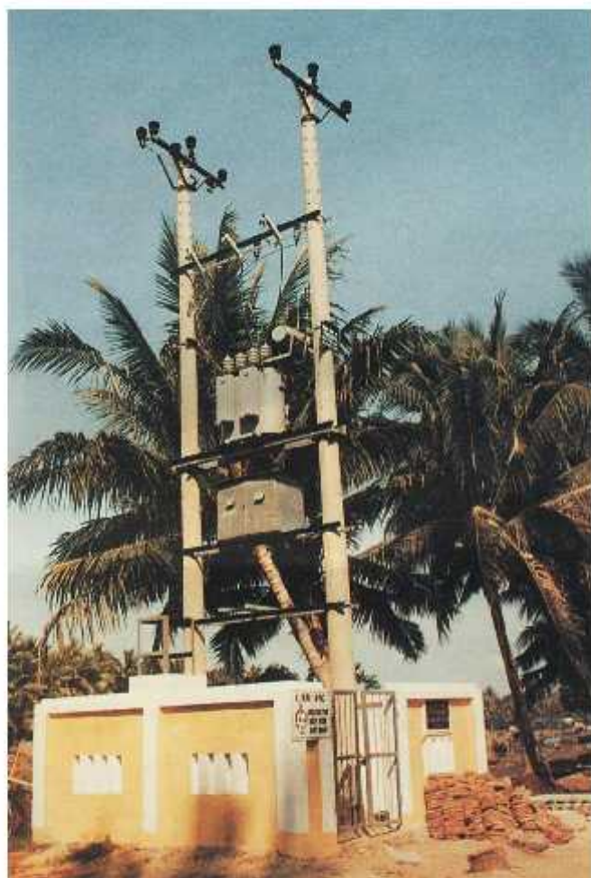
Trạm biến áp 100KVA-15(22) 0,4KV trị giá 140 triệu đồng do bạn đọc báo Thanh niên giúp nhân dân Tĩnh Khê - Sơn Tịnh
